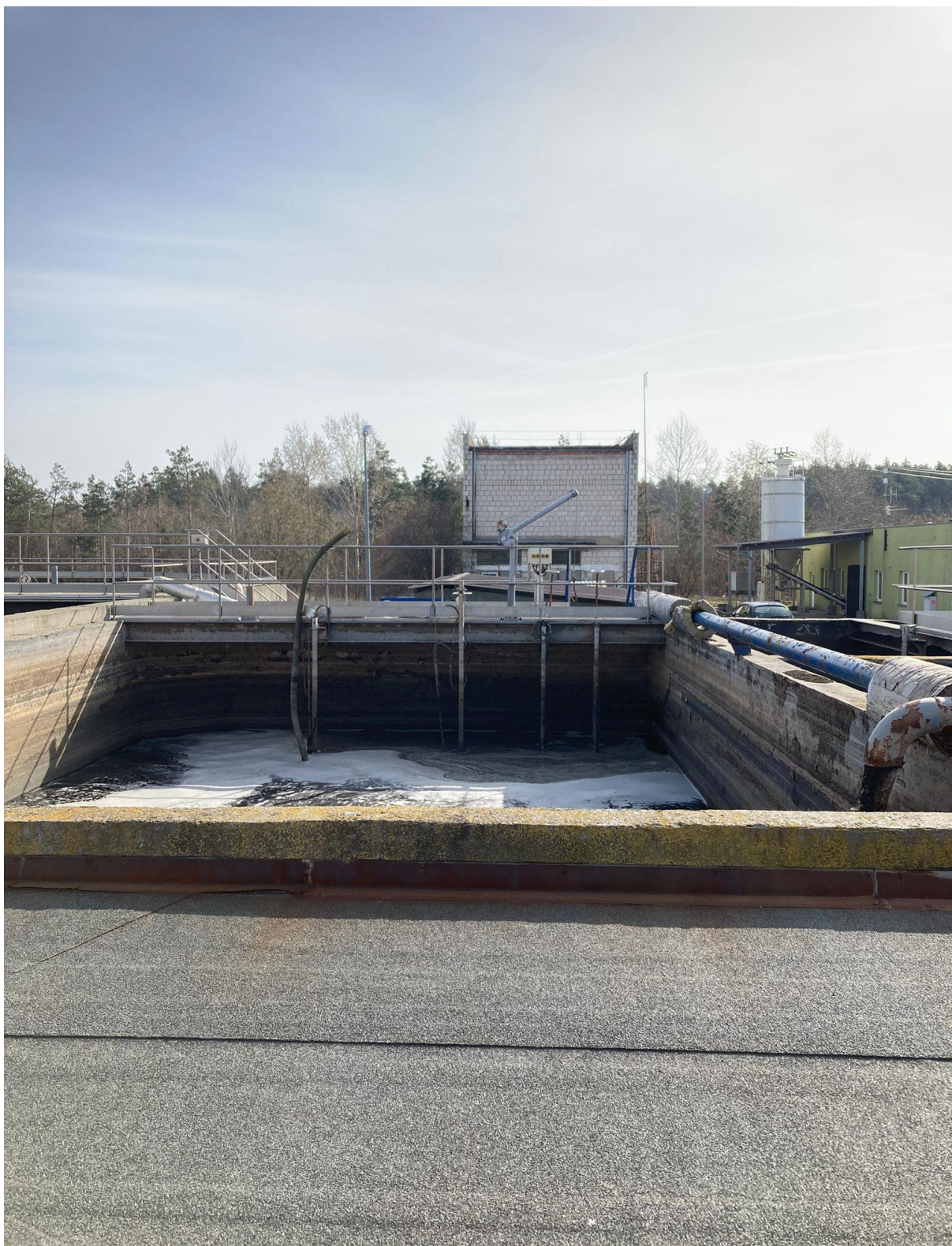
Rys.9 Widok zbiornika retencyjnego ścieków surowych
