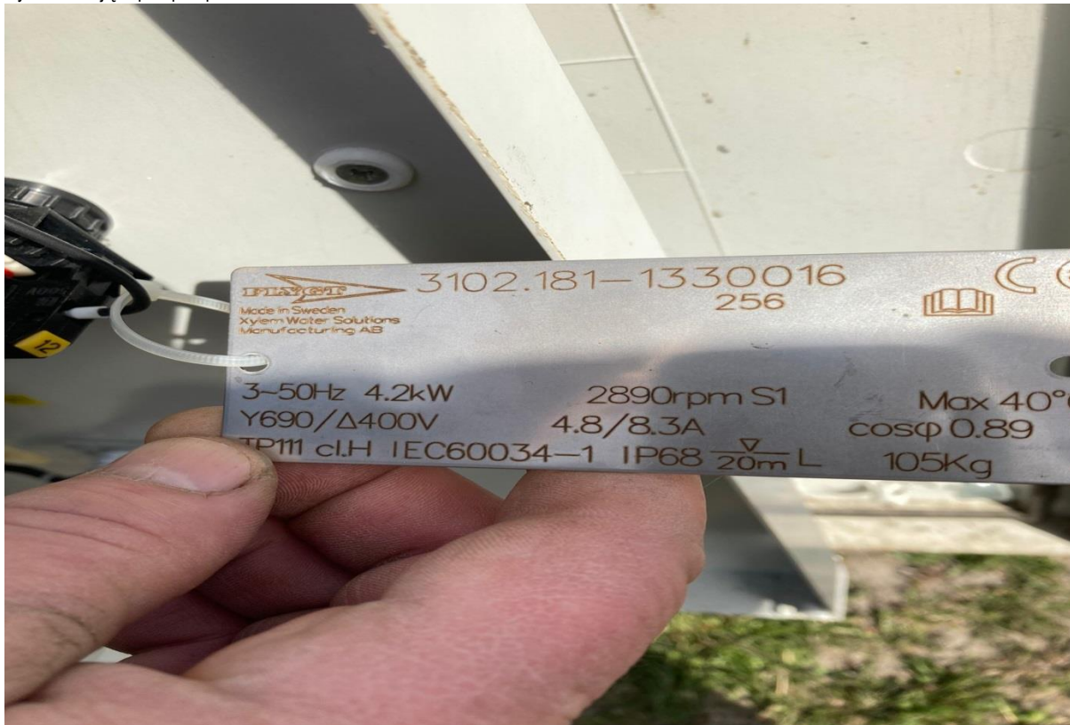
Rys. 6. Tabliczka znamionowa pomp w przepompowni P22
