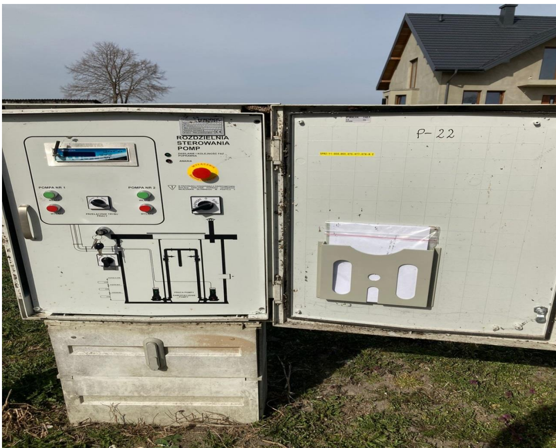
Rys.18 widok szafy sterowniczej przepompowni ścieków
