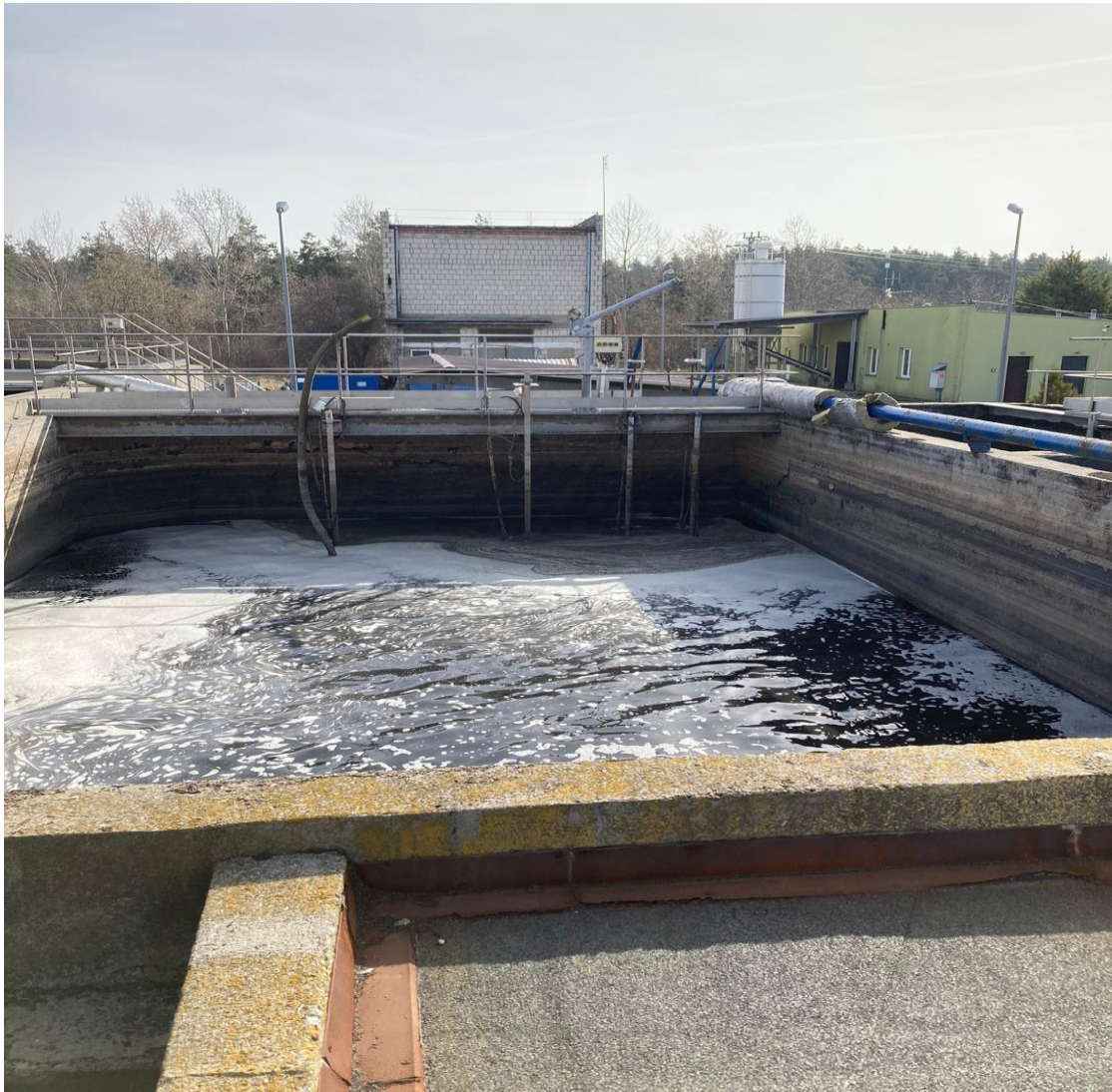
rys.21 widok na istniejący zbiornik ścieków surowych (w głębi podest obsługowy, po prawej rurociąg doprowadzający ścieki)
