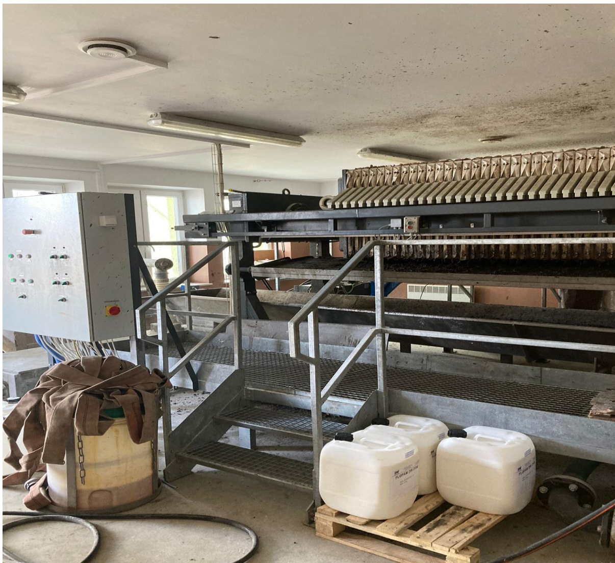
rys.22 widok na istniejącą prasę do odwadniania osadu nadmiernego
