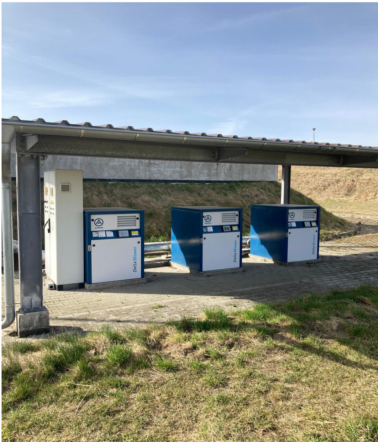
Rys.11. Widok stacji dmuchaw
