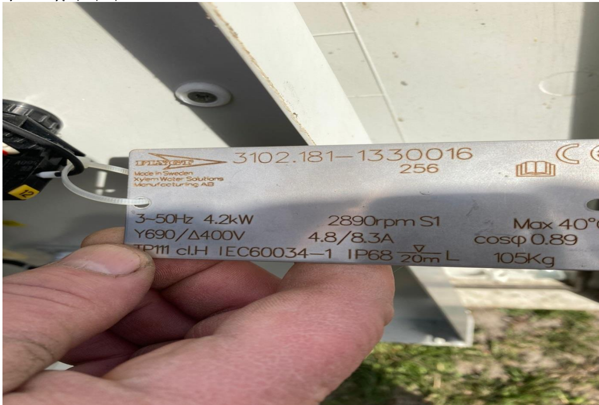
Rys. 6. Tabliczka znamionowa pomp w przepompowni P22
