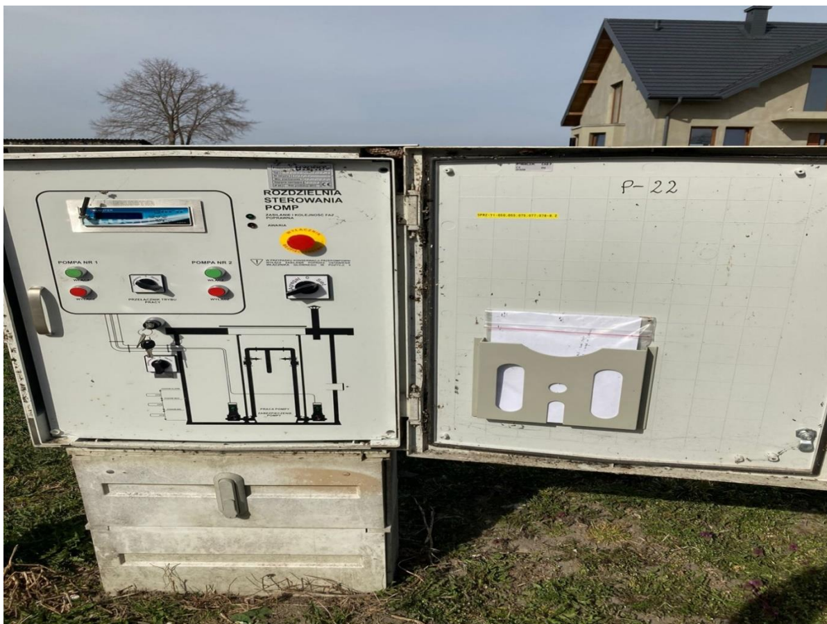
Rys.5. Istniejąca przepompownia P22
