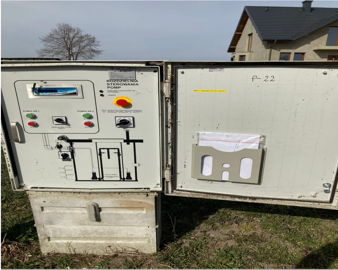
Rys.18 widok szafy sterowniczej przepompowni ścieków
