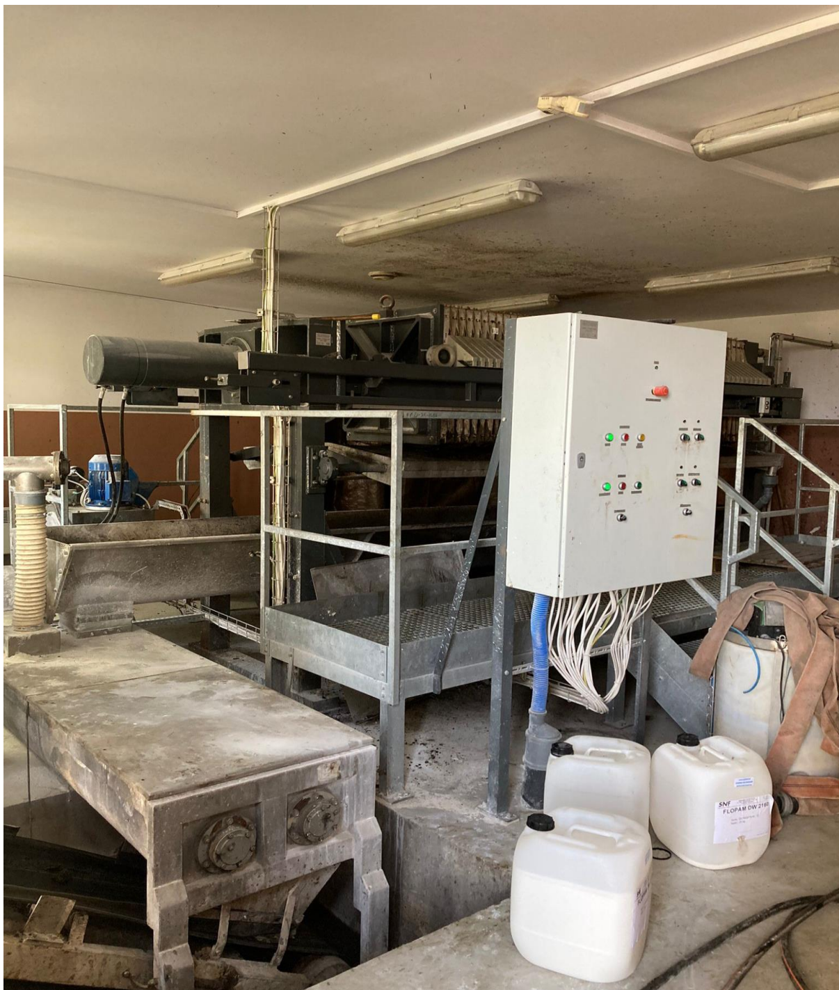
Rys.10 Widok istniejącej prasy osadu
